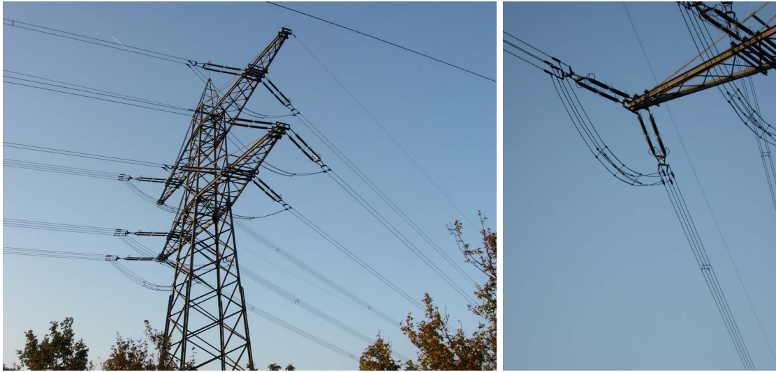
Abbildung 5.3.2.: Hochspannungsleitungen mit zusammengesetzten „Drähten“, bei denen mehrere leitend miteinander verbundene Einzeldrähte über Abstandhalter einen großen „Draht“ bilden, um die Feldstärke zu reduzieren.
